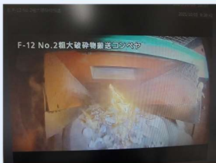
写真：⑤搬送C/V、貯留ドラム
