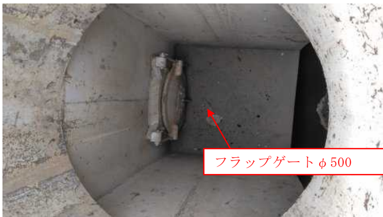
写真 7-2 思川側の放流部マンホール内のフラップゲートφ500mm
