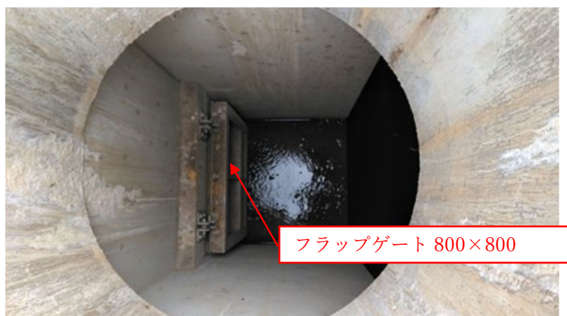
写真 2-1-1 放流部マンホール内のフラップゲート 800×800mm
