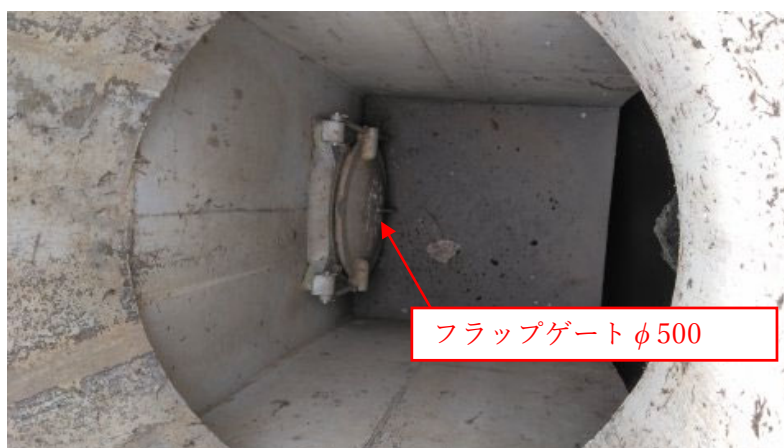
写真 2-1-2 思川側の放流部マンホール内のフラップゲート φ500mm
