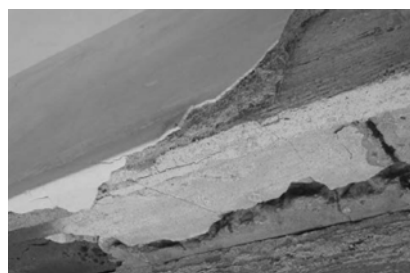
モルタルの浮き・剥落
