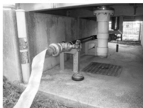
応急給水栓の設置例
