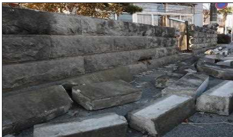
大谷石塀の倒壊
