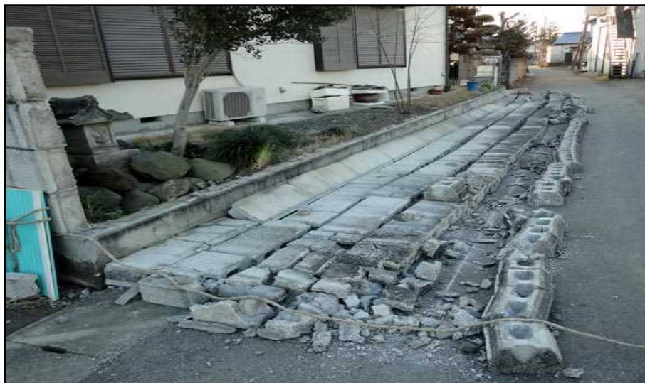
ブロック塀の倒壊
