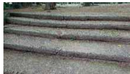
亀裂があり手すりのない階段
