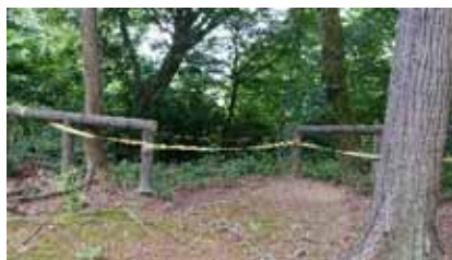
外周柵の破損
