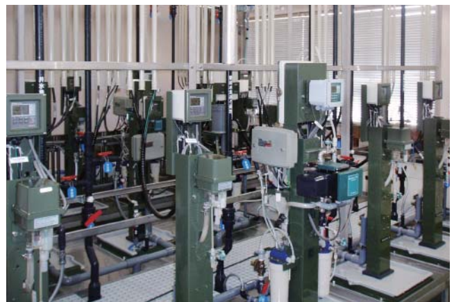
羽川西浄水場 「水質連続自動測定器」
