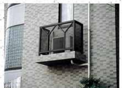
室外機を周囲から見えにくいように工夫している
