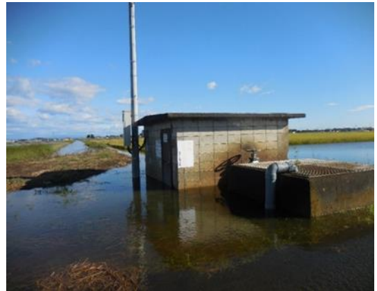
塩沢地内揚水ポンプ
