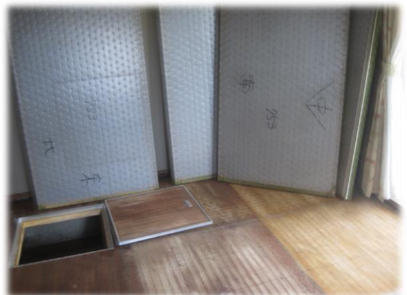
【押切市営住宅 内部被災状況】
