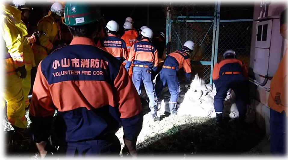
【小山市大字白鳥：与良川第2排水機場】
