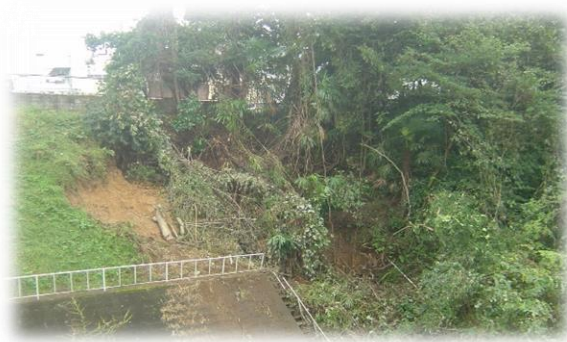
【喜沢取水塔河川占用隣接法面崩落】
