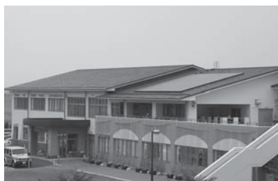
しらすぎ館に設置された太陽光発電パネル
