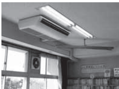
小学校図書室のエアコン
