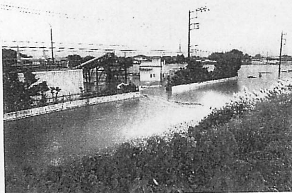
水没した柚井木川排水機場
