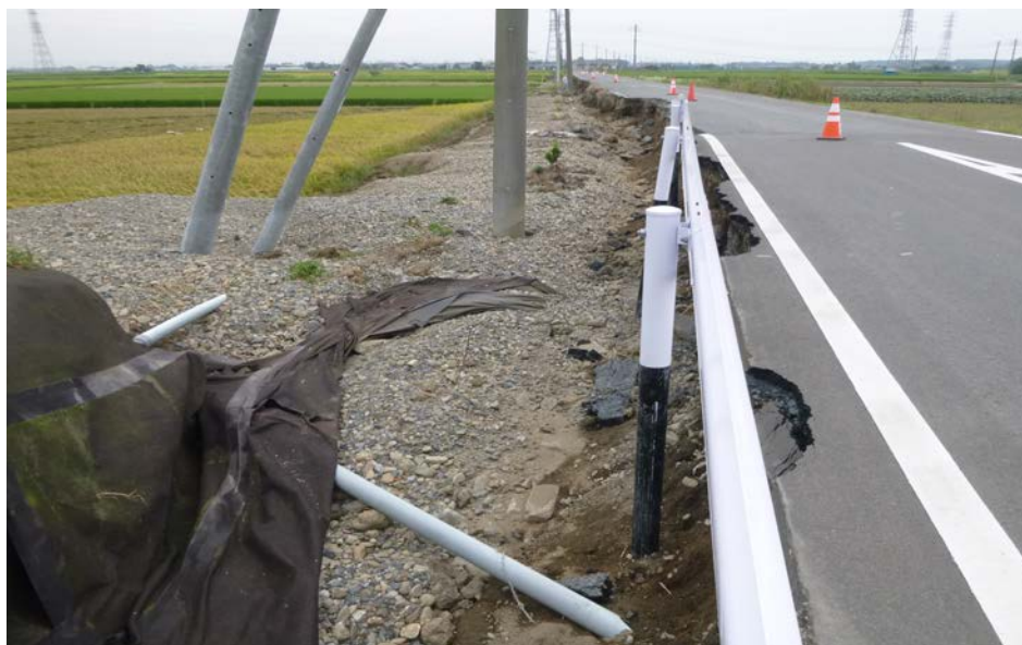
市道201号線（渋井地内）法面崩壊・舗装破損の様
