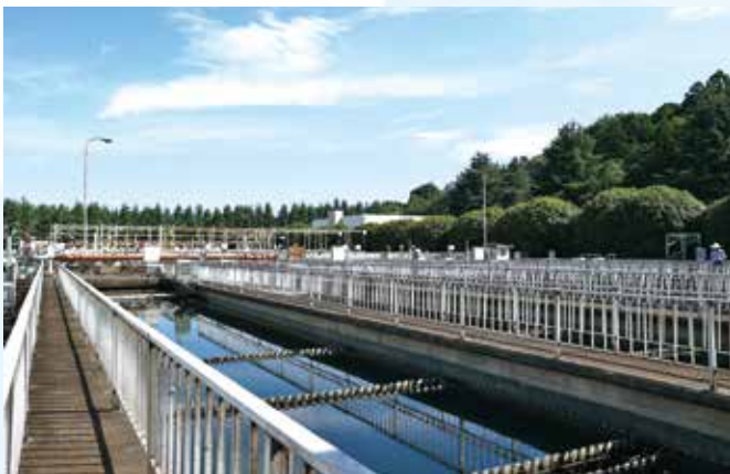
▲小山水処理センター
