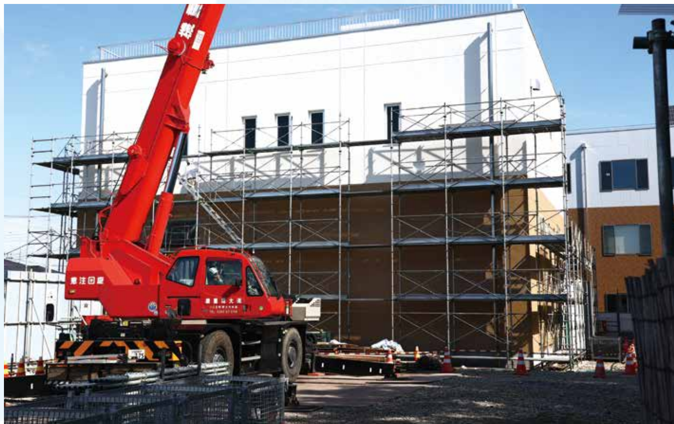
▲城南污水中継ポンプ場（令和5年4月に運行予定）
