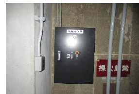
小ホール舞台上手 緞帳操作盤
