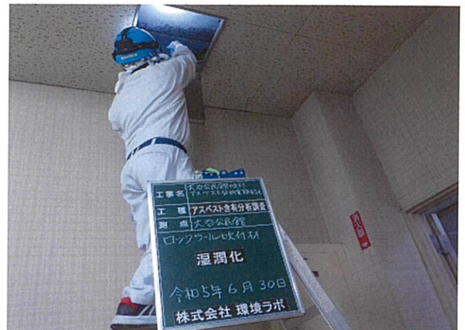
大谷公民館 天井裏 ロックウール吹付材 湿潤化
