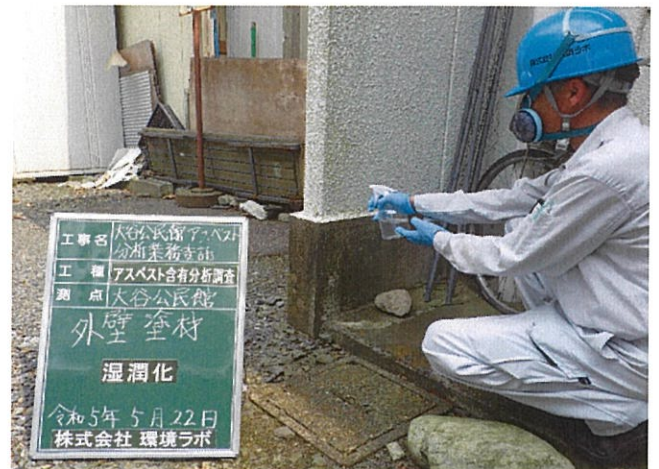
大谷公民館 外壁 外壁塗材 湿潤化
