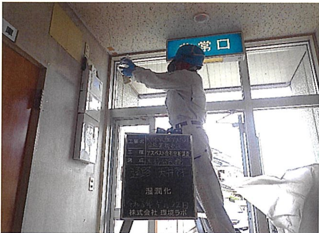
大谷公民館 通路 天井 天井材 湿润化
