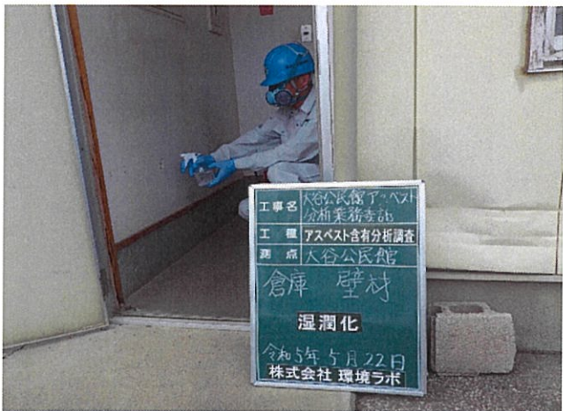
大谷公民館 倉庫 内壁 壁材 湿潤化
