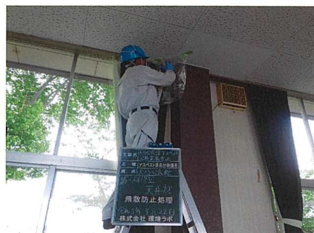
大谷公民館 第一研修室 天井 天井材 飛散防止処理
