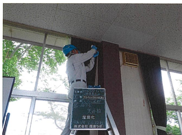
大谷公民館 第一研修室 天井 天井材 湿潤化
