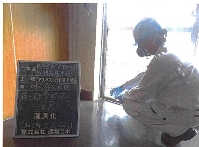
大谷公民館 第二研修室 床 長尺シート 湿润化
