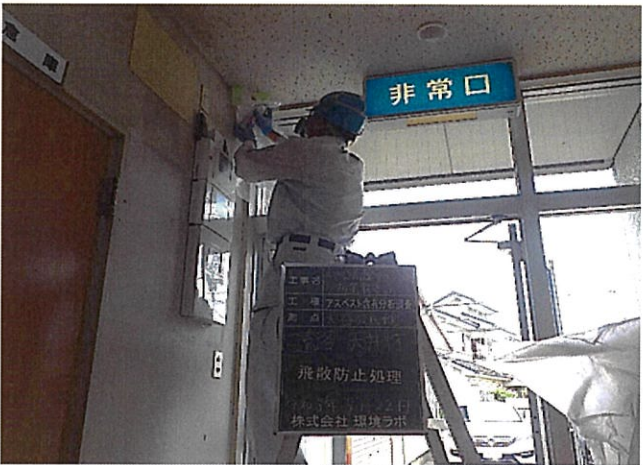
大谷公民館 通路 天井 天井材 飛散防止処理
