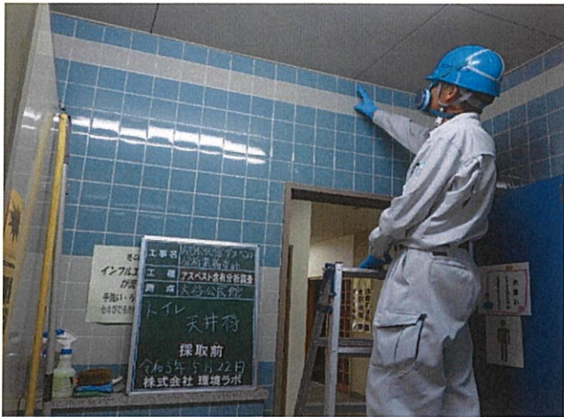
大谷公民館 トイレ 天井 天井材 採取前
