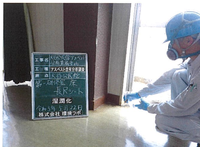
大谷公民館 第一研修室 床 長尺シート 湿潤化
