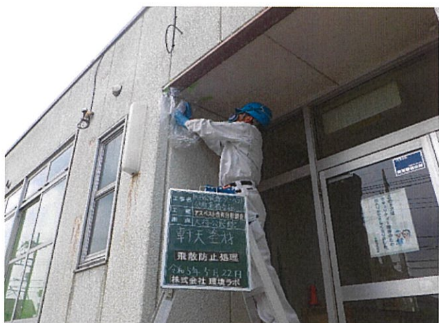
大谷公民館 軒天 軒天塗材 飛散防止処理
