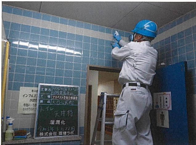
大谷公民館 トイレ 天井 天井材 湿潤化
