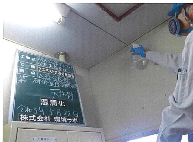
大谷公民館 第一研修室(空調機械室) 天井材 湿潤化
